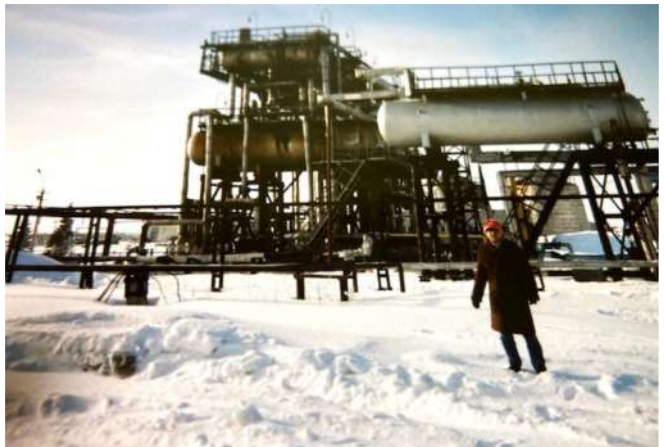
コミオイルへ納入した石油・ガス・水分離プラント
